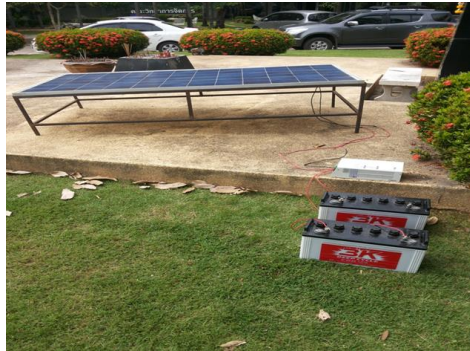
ภาพที่ 8 ระบบเซลล์แสงอาทิตย์สำหรับการชาร์จประจุลงแบตเตอรี่
